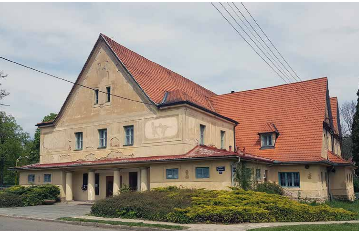
Sokolovna 2020 – havarijní stav fasády..
